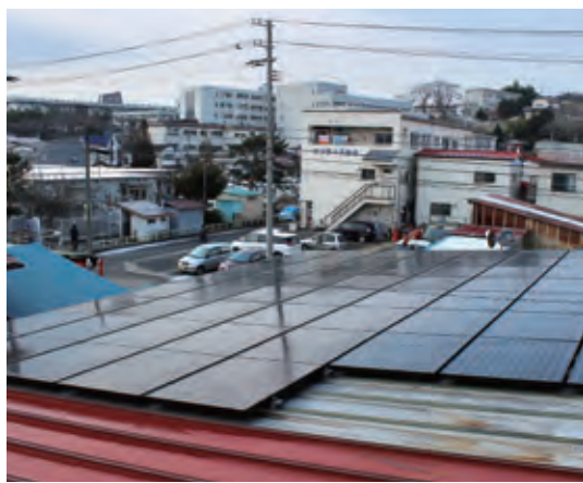
震災後に千葉誠本社屋上に設置した太陽光パネル
